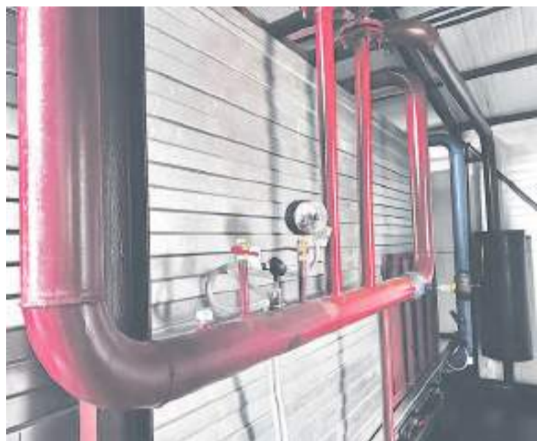
В новой котельной п. Линеvский Смоленского района.
