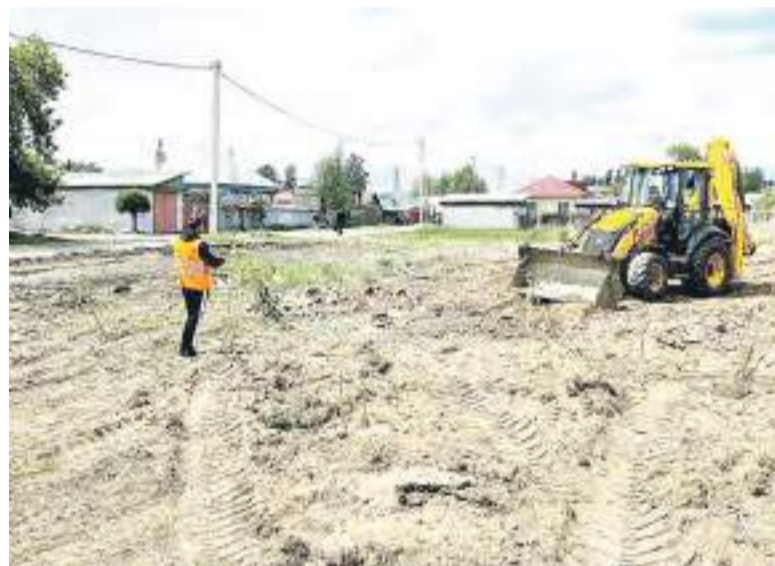
Прилегающая территория с западной стороны ДК «Строитель» по улице Одесской.
