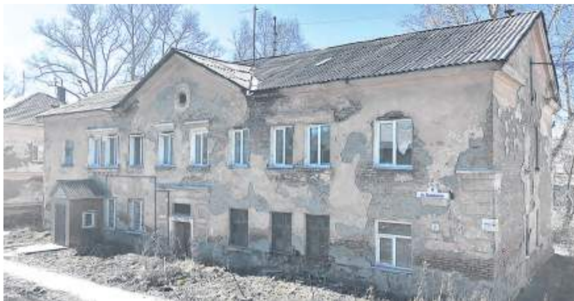
Частично обрушился фасад дома №4 по ул. Калинина.
