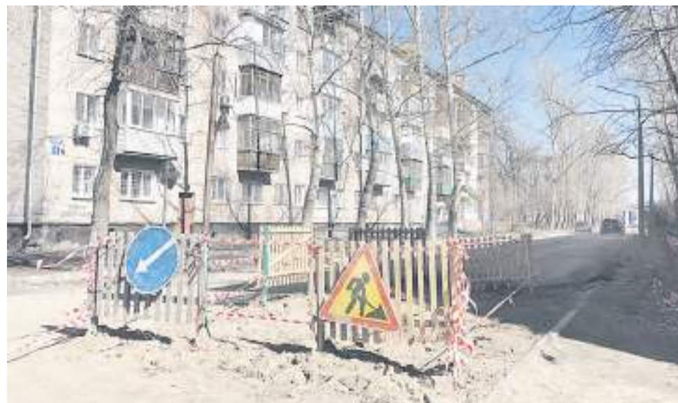
Крупная авария на главном городском коллекторе по ул. Громова, 5 устранена.
